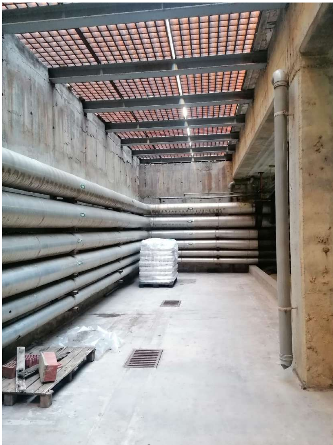
ÀREA DE LOGÍSTICA I MANTENIMENT. Espai d'instal·lacions
