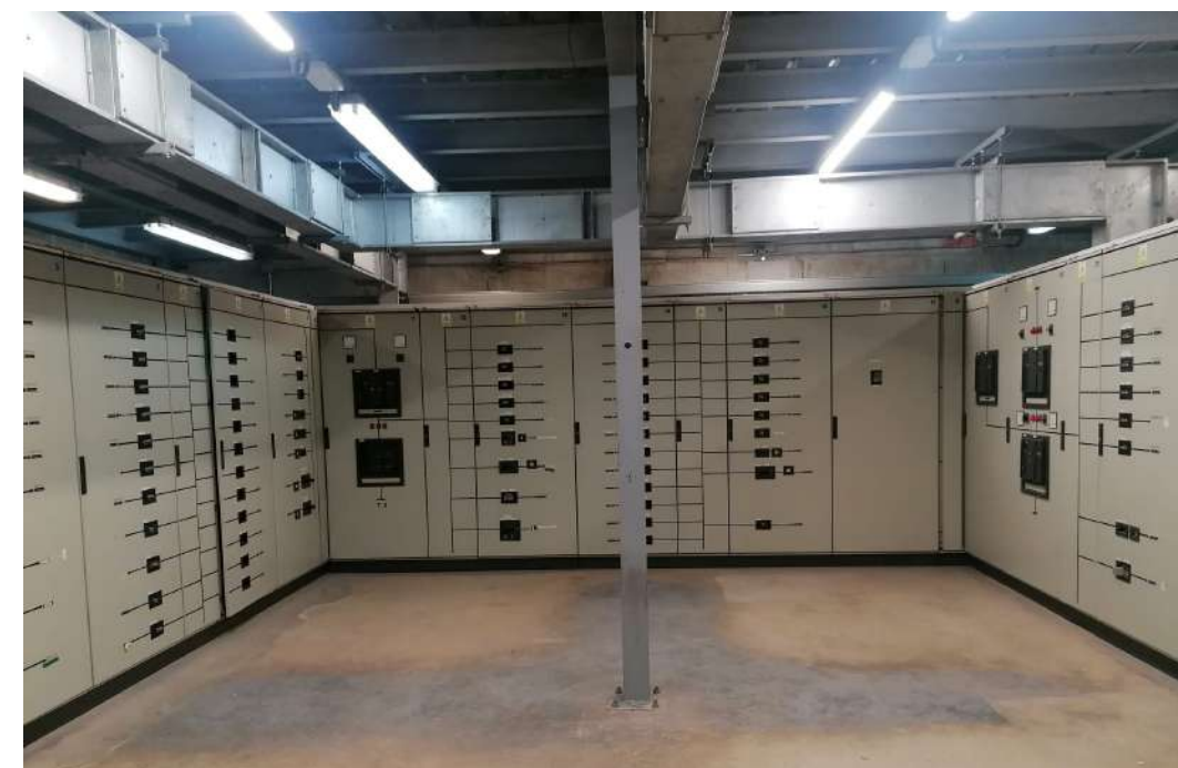
ÀREA DE LOGÍSTICA I MANTENIMENT. Espai d'instal·lacions
