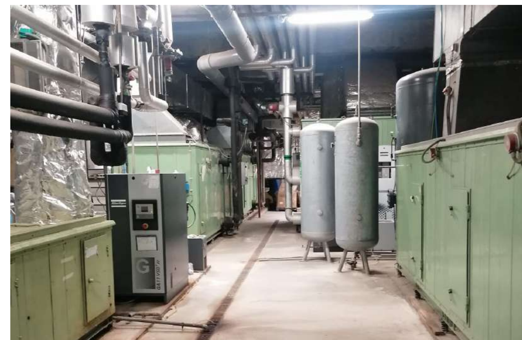
ÀREA DE LOGÍSTICA I MANTENIMENT. Espai d'instal·lacions
